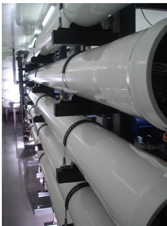
Foto 1: RO proefinstallatie Vitens, Pb Noardburgum. De installatie is opgesteld in een zeecontainer
