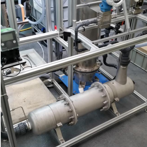
Afbeelding 1: Geoptimaliseerde UV/H 2 O 2 -reactor bij pompstation Heel.
