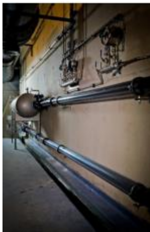
Afbeelding 1. De pilotinstallatie op productielocatie Welschap
