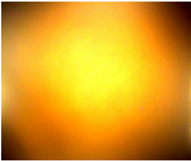
figuur 30 Opname van de leidingwand met de main trunk sampler voor spuien (het beeld is vaag, omdat de leiding dermate schoon is dat de camera met moeite scherp te stellen is)
