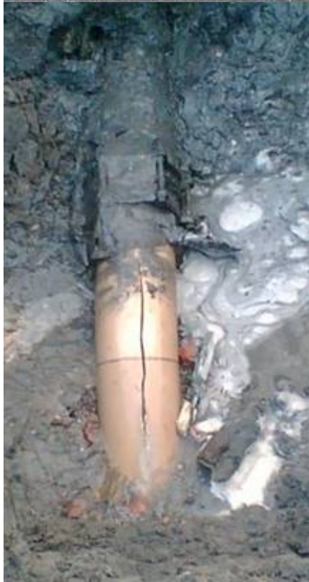
Lengtescheuren in PVC-buizen
