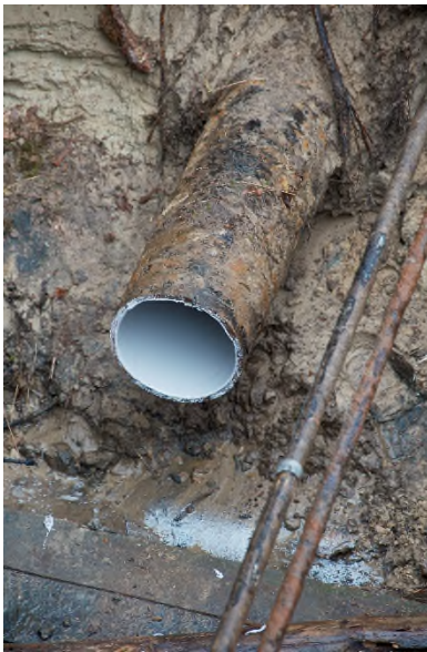
Figuur 12 Voorbeeld van polyurethaan coating. Foto gebruikt met goedkeuring van BAM Energie, Infra en Water
