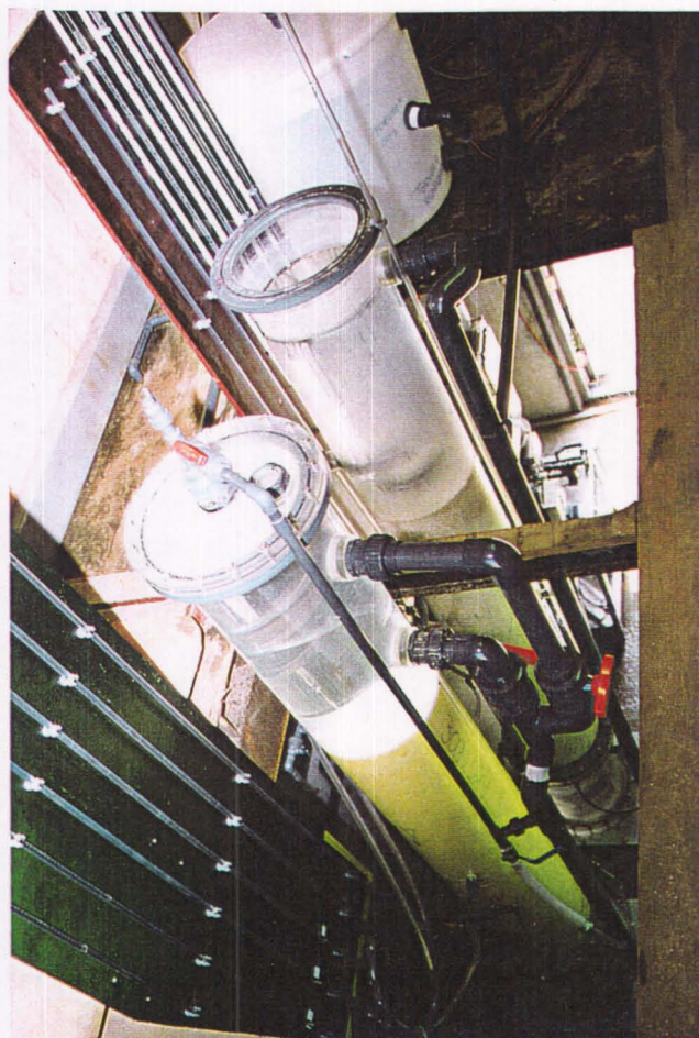
Proefinstallatie gescheiden zwavel- en kalksteenreactoren
