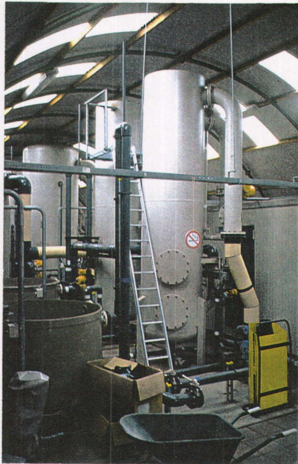
Nafilters van de proefinstallatie te Vierlingsbeek
