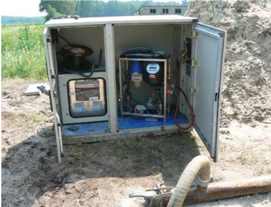
Monitoringsysteem op een meetlocatie langs de vulleiding Son-Vierlingsbeek.
