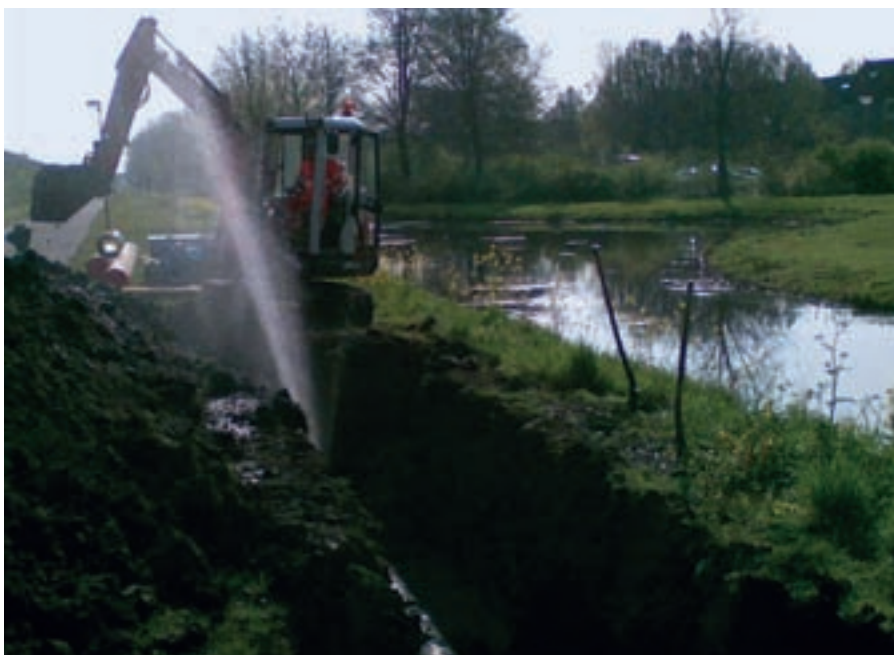
'Onbegrepen' lekkage in een PVC-leiding.
