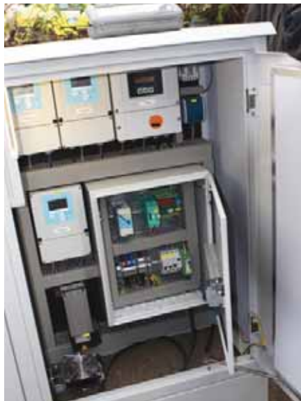
Eén van de 17 kasten met meetapparatuur die in het kader van het PSOM-project in Roemenië zijn geïnstalleerd.
