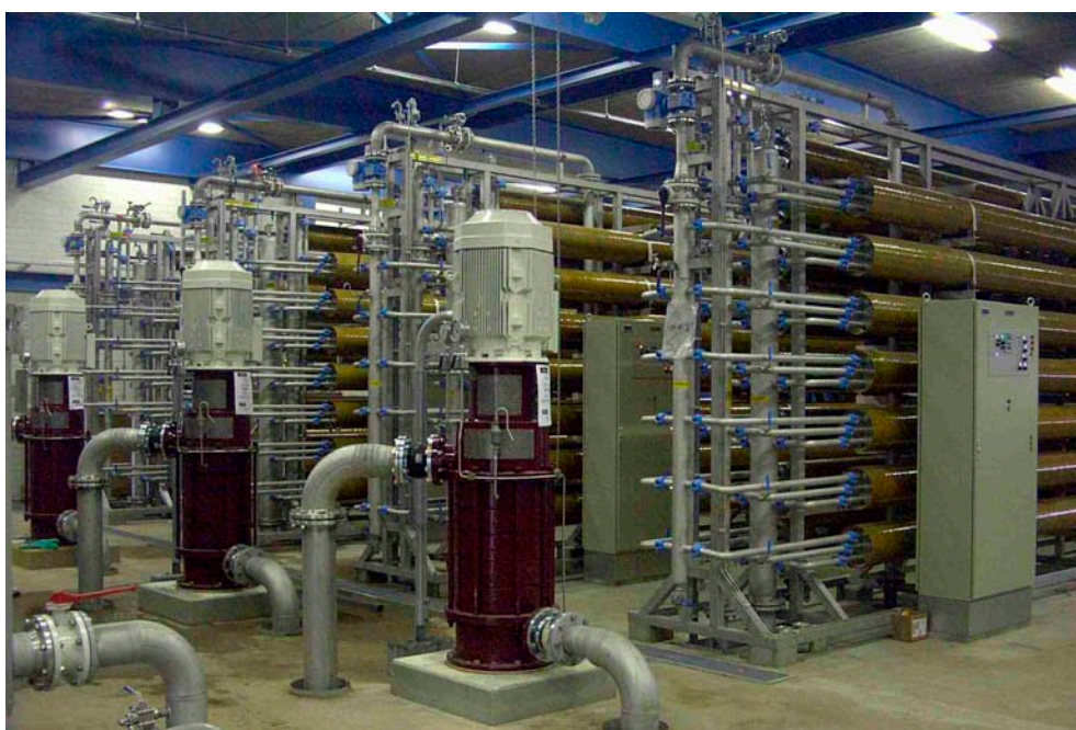
Figuur 3 Anaërobe nanofiltratie op pompstation Engelse werk
