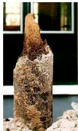
Figuur 22 Door paalrot aangetaste heipaal
