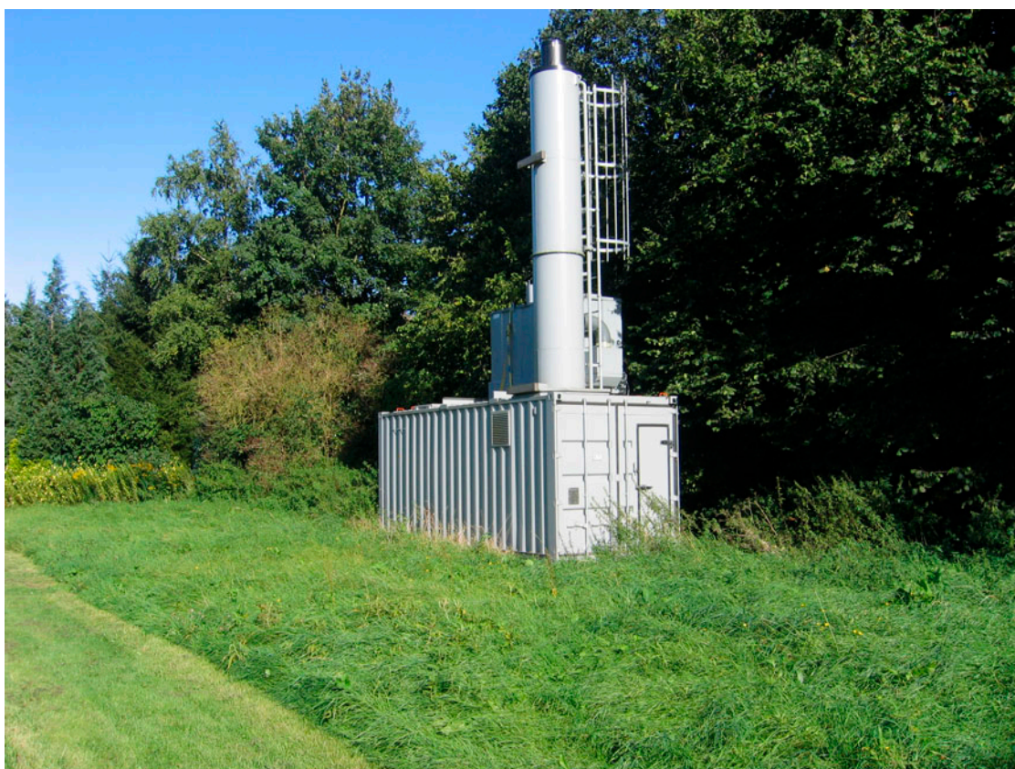
foto 1: De stripper is met het ontijzeringsfilter in een container geplaatst
