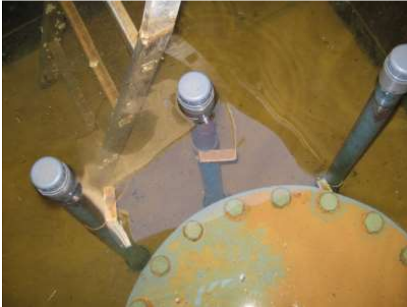
Figuur 2-2 Putkelder vol water (foto Brabant Water). Doordat de waarnemingsfilters voldoende hoog zijn afgesteld en zijn voorzien van een waterdichte kap, kan er geen water in stromen.
