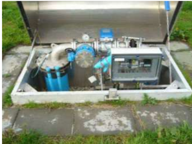
Figuur 2-3 Putkelder met putkop, peilbuizen en elektrische installatie. De putkelder staat op een terp waardoor ze beschermd is tegen overstromingen (foto Waterbedrijf Groningen).
