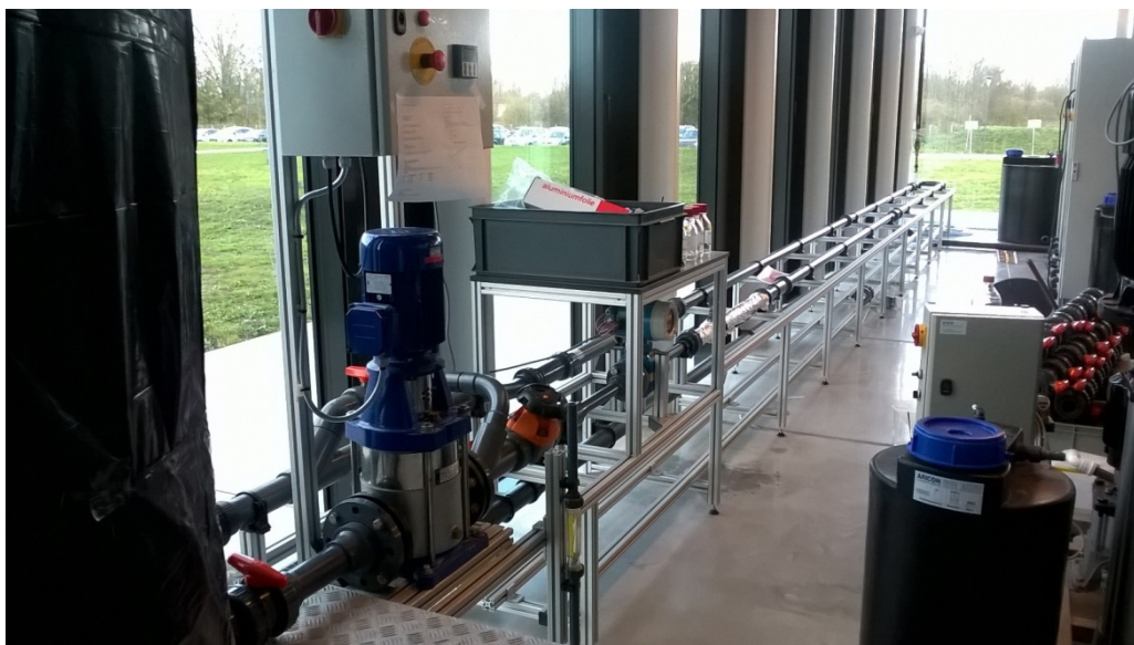
FIGUUR 2. PROEFOPSTELLING IN DE PROEFHAL. LINKS HET SPIUVAT, GEVOLGD DOOR DE SPIUPOMP EN DE 20-METER LANGE LEIDING
