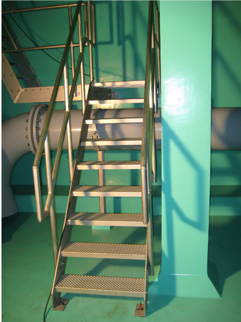
Figuur 10 Roestvaststalen trap in een drinkwaterreservoir.
