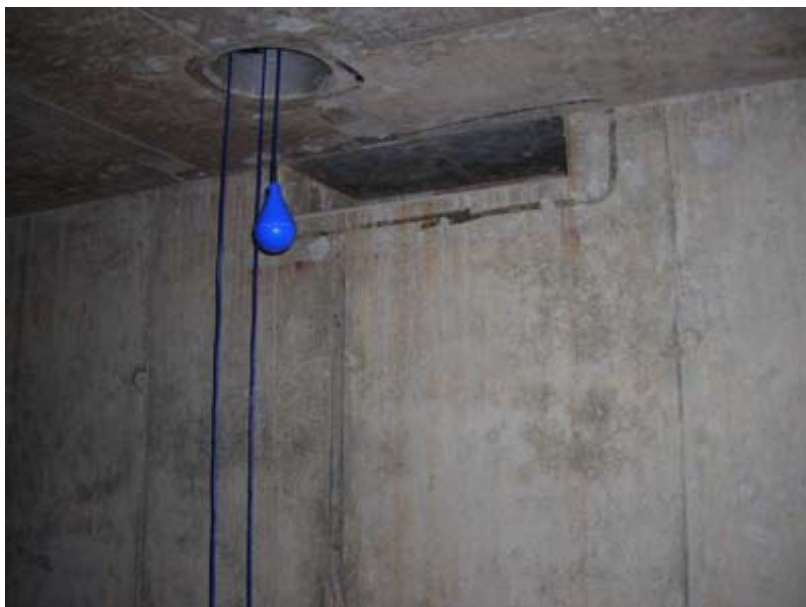
Figuur 12 Overloop van een drinkwaterreservoir met hoogniveaumeting.
