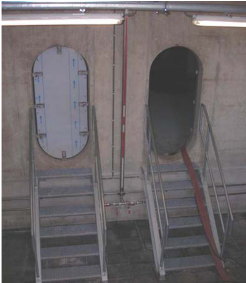
Figuur 9 Waterdichte deuren in een drinkwaterreservoir.
