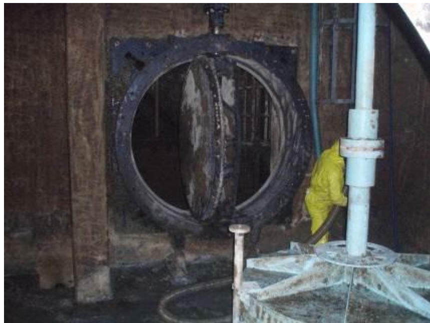
2.5 Werkzaamheden aan het uitlaatpompstation van spaarbekken 'Petrusplaat' (effectzone blauw) vallen binnen risicoklasse I (foto's Evides).
