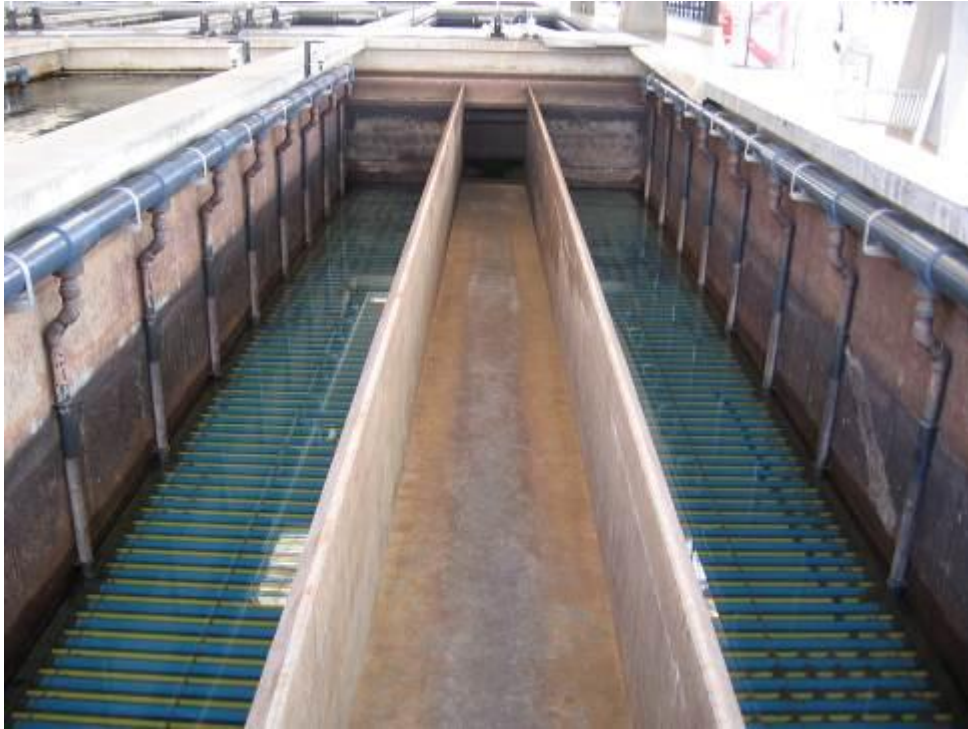
2.6 Werkzaamheden aan een snelfilter voor de behandeling van oppervlaktewater (effectzone oranje) met een relatief kleine kans op verontreiniging vallen in risicoklasse II (foto Evides).
