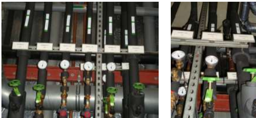
Figuur 25. Meetpunt in de schacht 2de verdieping.
