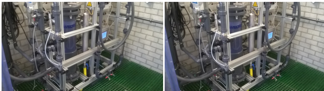
FIGUUR V-1 OZON INSTALLATIE
