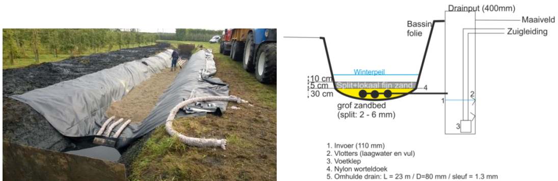
Figuur 3–9: Waterbodemfiltratie ter plaatse van Freshmaker Ovezande (afstromend oppervlaktewater)
