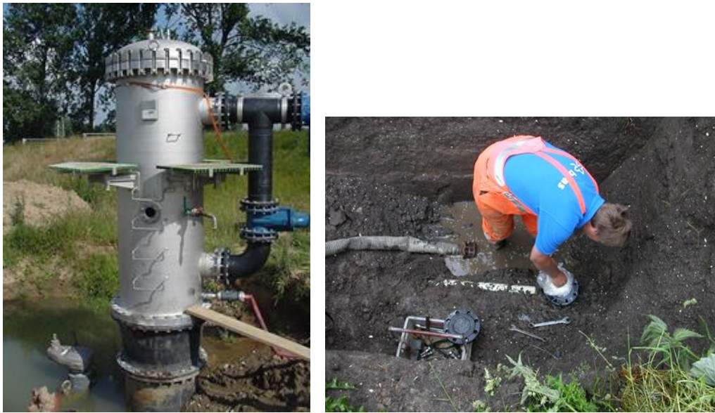
Figuur 35 Lanceerstukken zachte prop voor een leiding met grote diameter (Ø 600 mm, links (foto WML)) en een kleine diameter (Ø 100 - 150 mm, rechts (foto Vitens, destijds Hydron Flevoland)).
