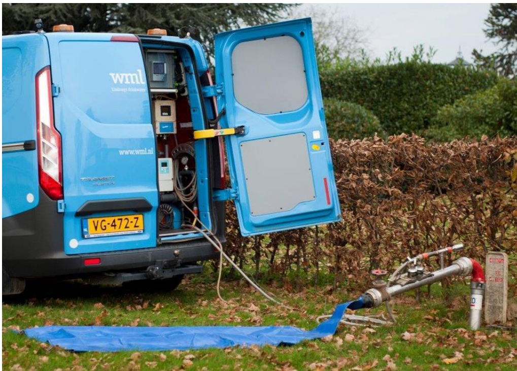
Figuur 15 Volledig ingericht meetpunt en aangepaste 'fittersbus'. Op het spui punt is vanaf de bocht de volgende apparatuur aanwezig: T-stuk met aftak naar drukopnemer en troebelheidsmeter, snelheidsmeter voor de volumestroom, afsluiter en spuizak. In de bus zijn de troebelheidsmeter, snelheidsmeter, drukregistratie en datalogger opgesteld (foto: WML, 2014).
