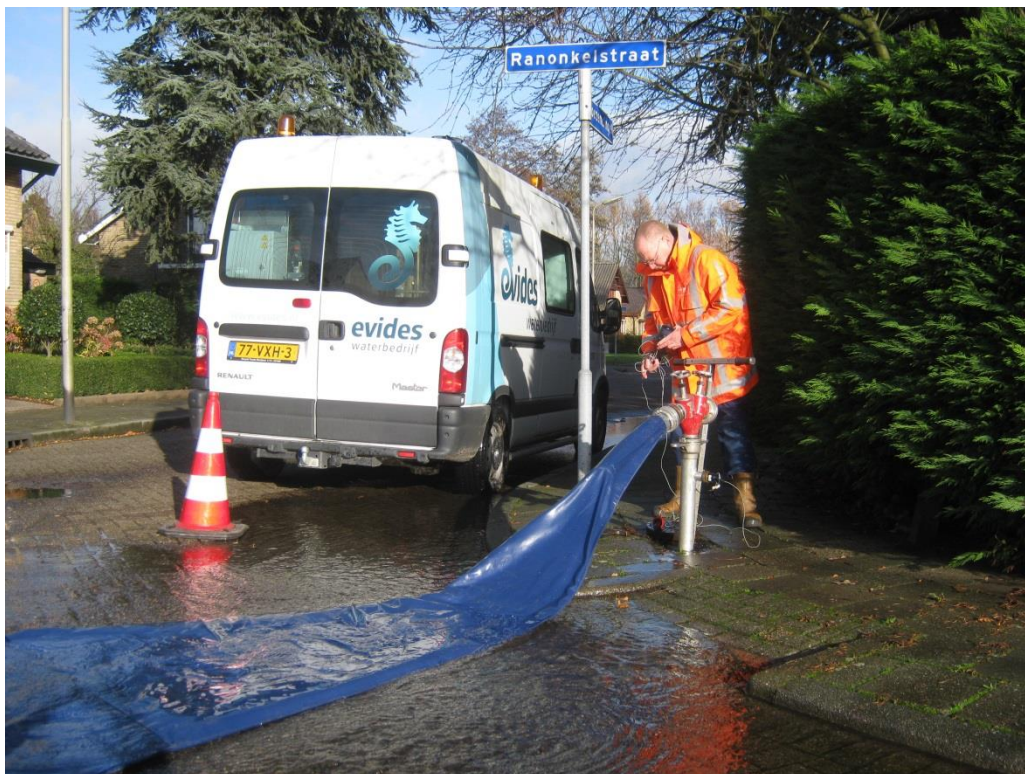
Figuur 27 Spuiactie door middel van waterspuien. Op de brandkraan is een 'spuizak' aangesloten, op de standpijp is een volumestroommeter aangesloten (foto Evides).
