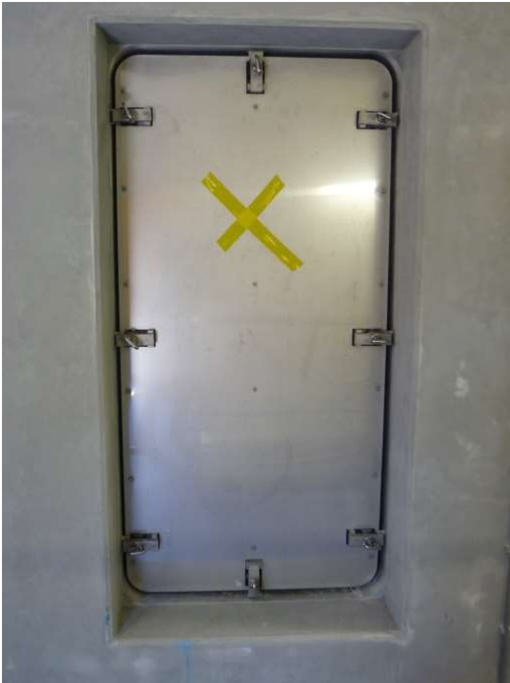
Figuur 9 Waterdichte deur in een drinkwaterreservoir.
