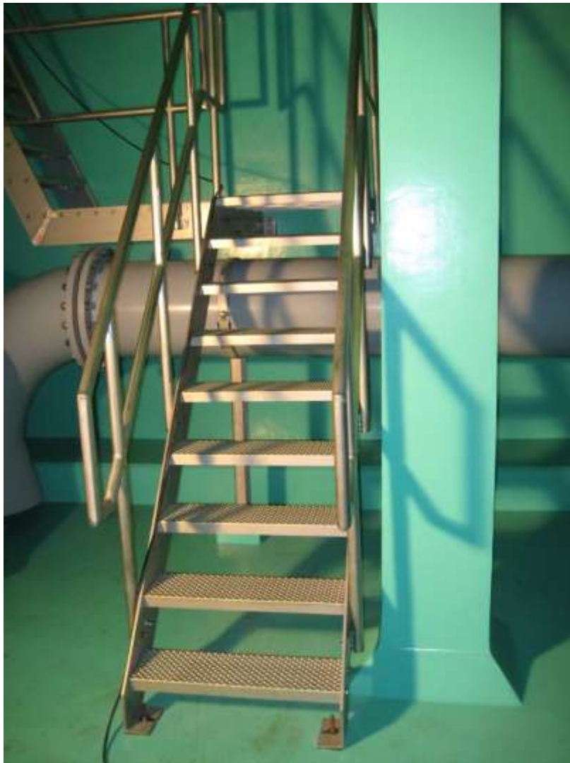
Figuur 10 Roestvaststalen trap in een drinkwaterreservoir.
