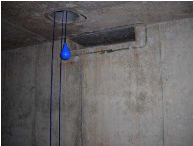
Figuur 13 Overloop van een drinkwaterreservoir met hoogniveaumeting.
