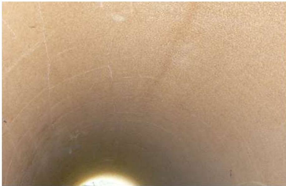
Figuur 7 Scheuren in de fabrieksmatig aangebrachte inwendige cementmortelbekleding van een \varnothing 900 mm stalen zinker. Onder deze scheuren was geen aantasting zichtbaar.
