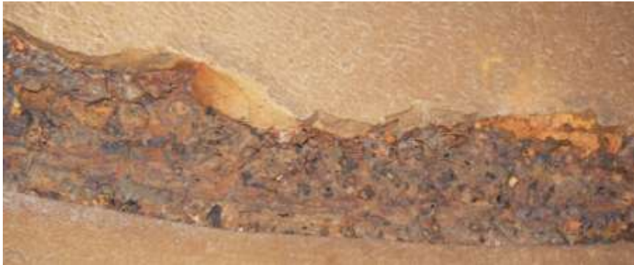
Figuur 10 Niet-aangesmeerde las in een stalen leiding na 17 jaar in bedrijf.
