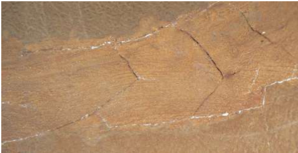
Figuur 8 Krimpscheuren in een in situ aangesmeerde cementmortelbekleding ter plaatse van een las. De aanwezige aantasting is weergegeven in Figuur 9.
