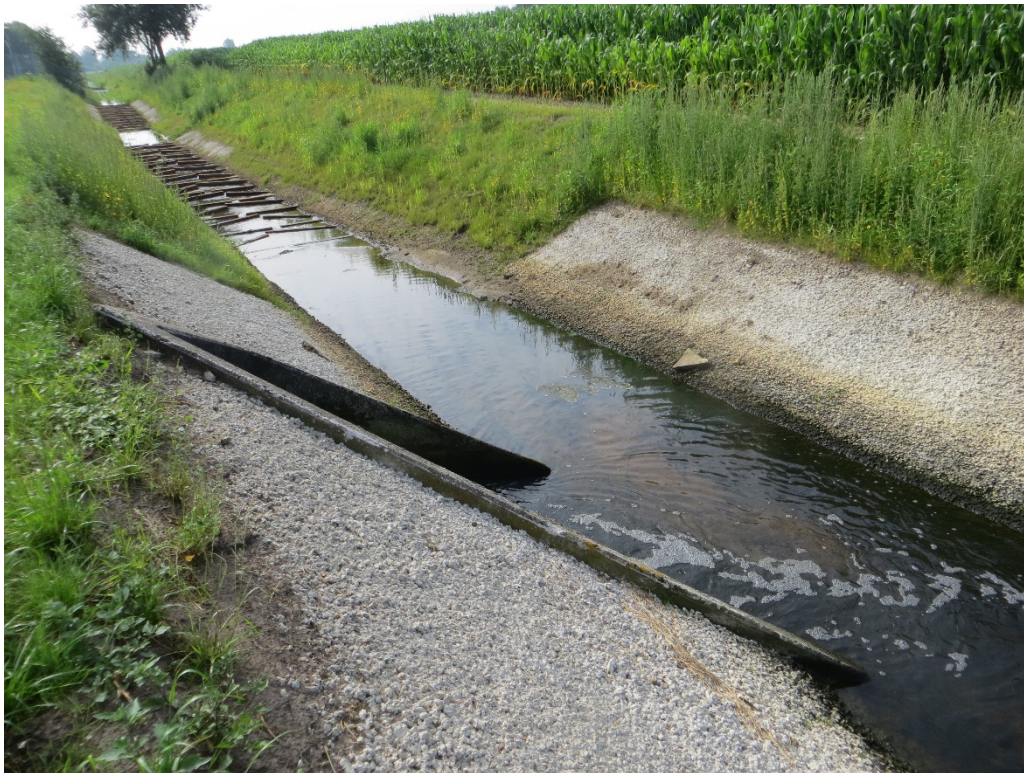
FIGUUR 4-1: VOEDING VAN DE BOLSCHERBEEK MET EFFLUENT (LINKS) IS IN DE ZOMERPERIODE GROTER DAN DE NATUURLIJKE AFVOER (RECHTS, OVER DE STUW). FOTO BOVEN BAS WORM, SITUATIE 8-7-2015. FOTO BENEDEN GÉ VAN DEN EERTWEGH, SITUATIE 18-7-2016.
