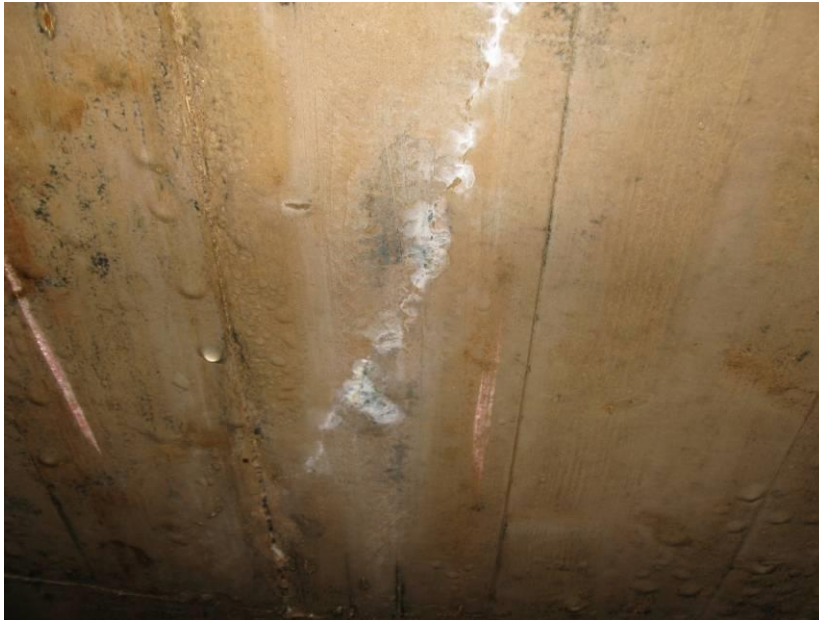
Foto 4 Kalkuitbloeiingen ter plaatse van scheurvorming in een dek.
