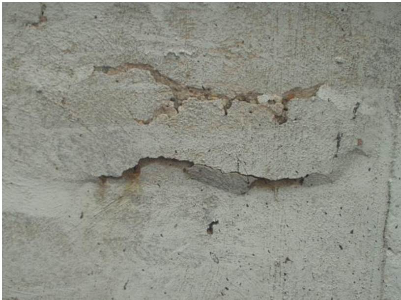
Foto 2 Afgedrukte betondekking (scholvorming) als gevolg van corrosie door onvoldoende betondekking.
