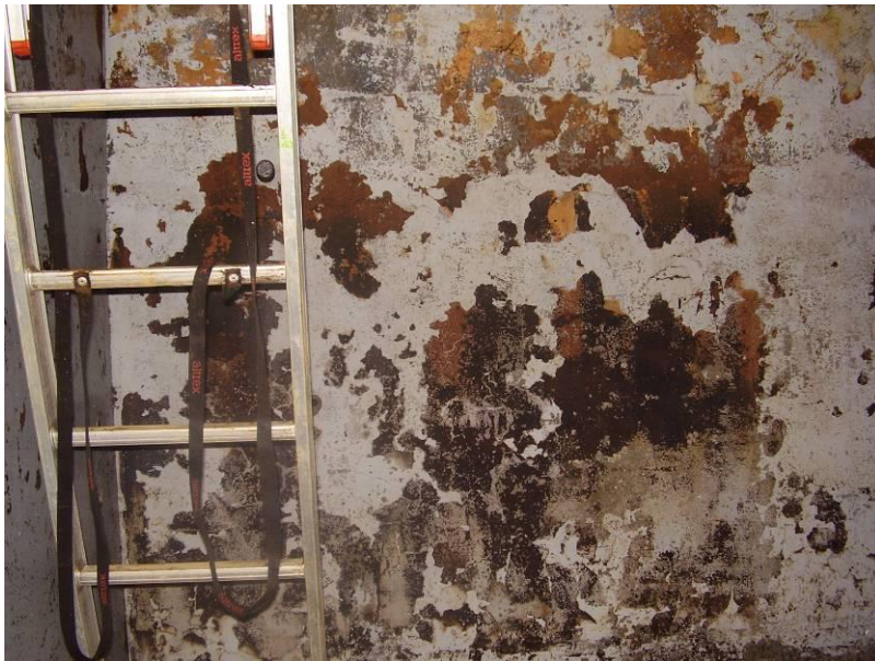
Foto 9 Beschadigde coating op wandconstructie als gevolg van erosie.
