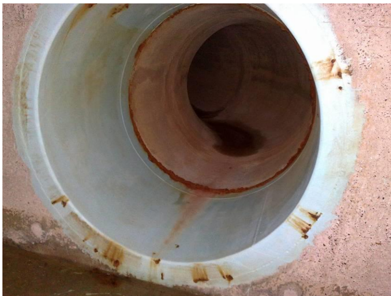
Foto 10 Beschadigde coating en corrosie aan ingestorte stalen doorvoer.
