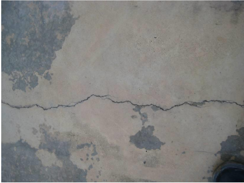
Foto 1 Scheurvorming in wandconstructie.
