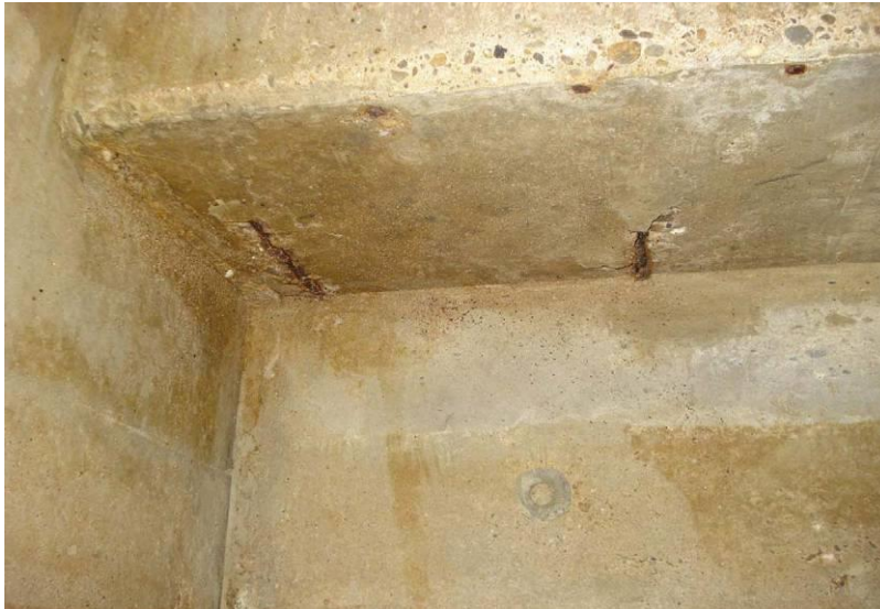
Foto 3 Plaatselijk corroderende wapening als gevolg van onvoldoende betondekking.
