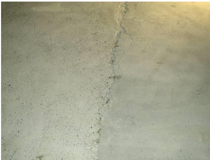
Foto 5 Onvlakheid ter plaatse van aangeheelde vloer.
