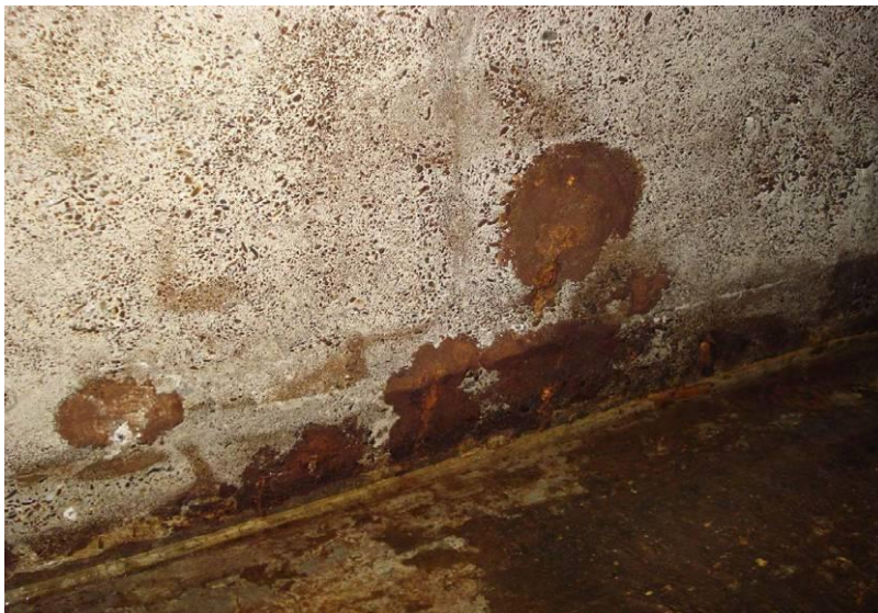
Foto 7 Biofilmvorming ter plaatse van vloer-wand aansluiting.
