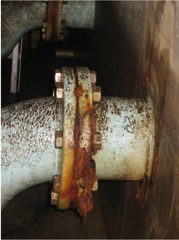
Foto 11 Corrosie van ingestort muurdoorvoerstuk.
