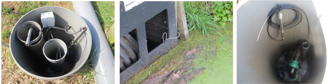
FIGUUR 5: LOCATIES VAN NIVEAUWAARNEMINGEN WATERSTANDEN IN AANVOERPUT (RECHTS), REGELPUT (LINKS) EN BIJ DUIKER IN KAVELSLOOT (MIDDEN).
