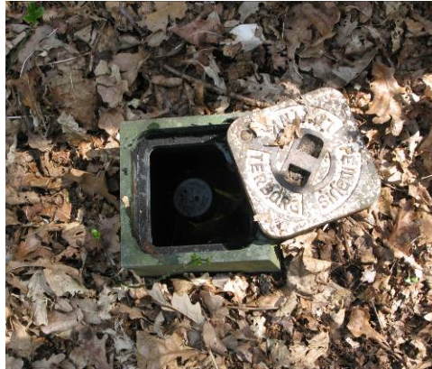
Figuur 21-8 Afwerking van een waarnemingsput aan maaiveld door middel van een straatpot.
