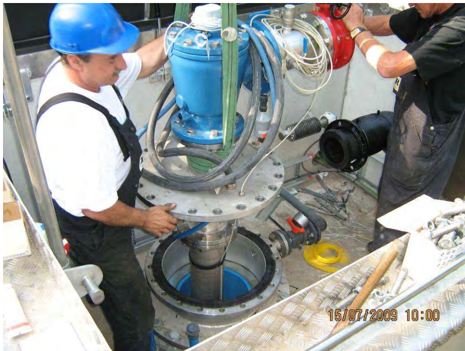
Foto 11-4 Het installeren van een pomp, haalbuizen en watermeter (Carl van Rosmalen, Brabant Water)
