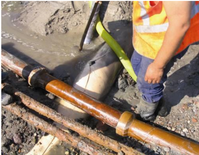
Figuur 5-3. Graafwerkzaamheden waarbij direct contact ontstaat tussen open drinkwaterleiding en rioolwater.
