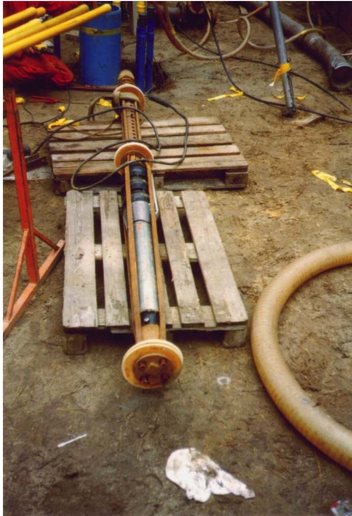
Foto 15-5 Een rondpompapparaat gebruikt voor regeneratie . Onderaan de pomp, bovenaan het deel waar het water terug wordt gebracht (C. van Rosmalen, WOB)
