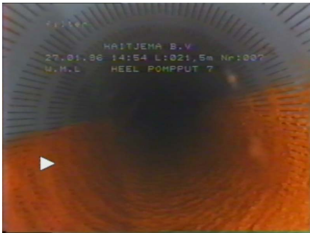
Foto 15-3 Eenzijdige putverstopping door aantrekken van water uit een bekken (Pompstation Heel, WML, M. Juhász, WML)
