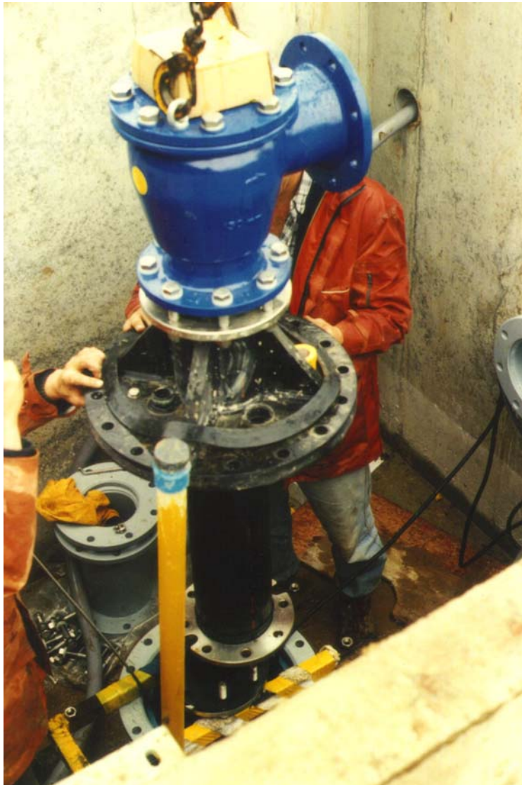
Foto 11-4 Het installeren van een putkop en afhangen van de pomp (M. Balemans, Kiwa)
