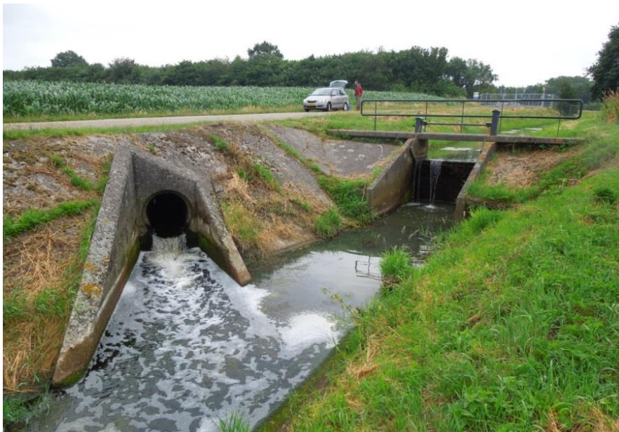
FIGUUR 4-1 RWZI-EFFLUENT LOZINGSPUNT OP DE BOLSCHERBEEK BIJ HAAKSBERGEN IN DE ZOMER VAN 2015. LET OP HET VERSCHIL TUSSEN DE ZEER BEPERKTE ‘NATUURLIJKE’ AFVOER OVER DE STUW EN DE OMVANG VAN DE EFFLUENTSTROOM (FOTO: BAS WORM).
