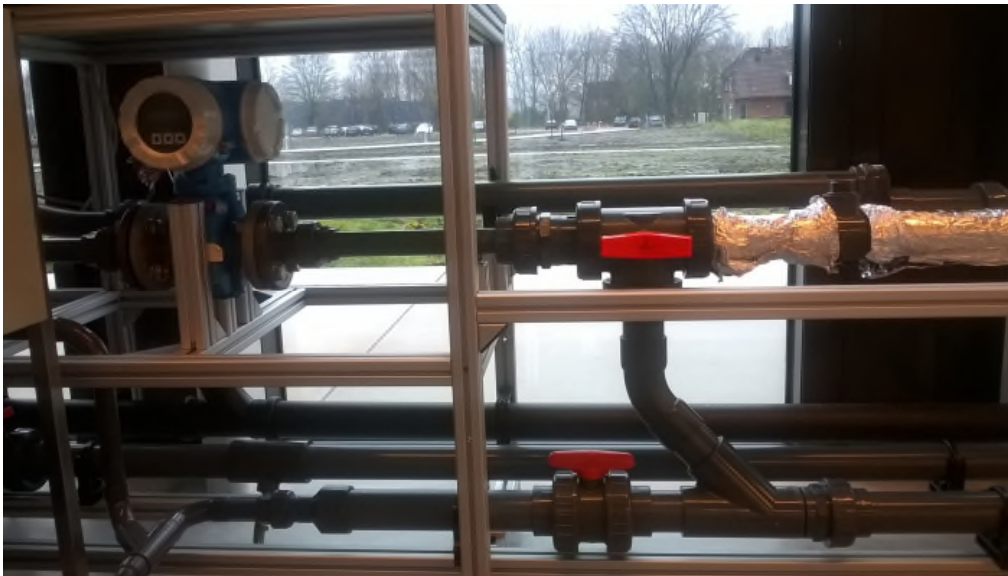
FIGUUR 5. VERBINDING TUSSEN WATERAANVOER VOOR SPUIEN (BOVENSTE LEIDING, LINKS VAN DE 3- WEGKLEP) EN DISTRIBUTIESYSTEEM (ONDER). DE BOVENSTE AFSLUITER STUURT HET WATER OMLAAG HET DISTRIBUTIESYSTEEM IN. DE ONDERSTE AFSLUITER VOORKOMT DAT SPUIWATER IN DE VERKEERDE RICHTING STROOMT
