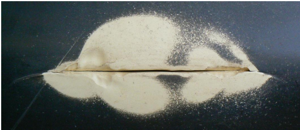
Figuur 15 Breuk met een lange looptijd in \varnothing 500 mm PVC leiding, de lengte van de breuk bedraagt ongeveer 350 mm. De buitenzijde van de buis is gefotografeerd.
