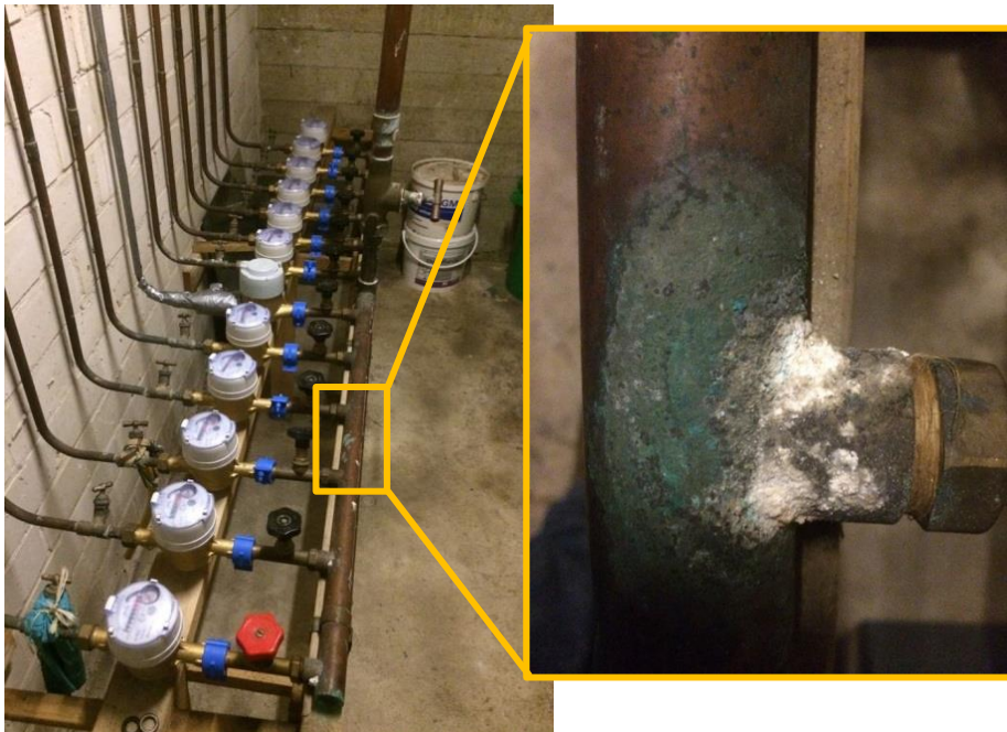
CORROSIE AAN KOPEREN VERDEELSTUK.
