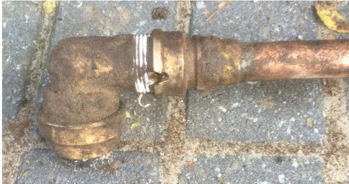
EROSIE AAN MESSING OVERGANGSKOPPELING DOOR PUNTLEKKAGE.
