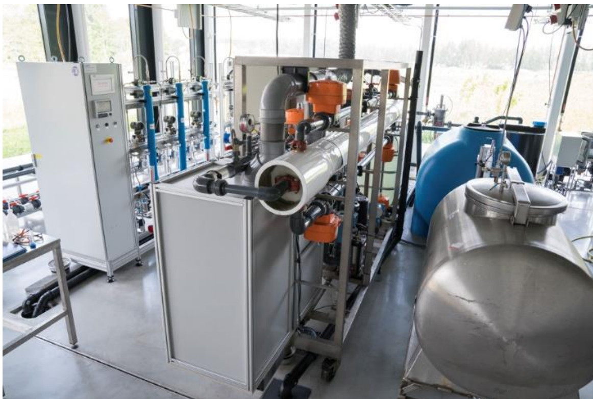
Afbeelding 2 RO- (linksachter) en UF- (middenvoor) installatie gebruikt tijdens SW-RO onderzoek
