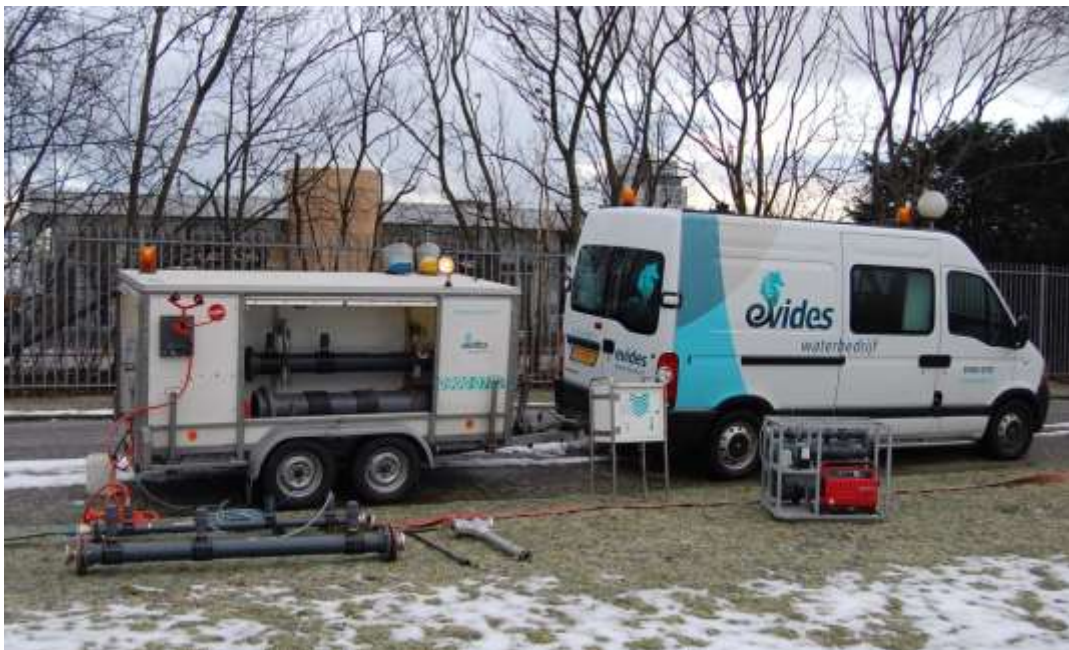
Foto bij onderdeel 18 van checklist 3.7 Voorzieningen voor de eventuele desinfectie van leidingen na waterkwaliteitsbeoordeling.
