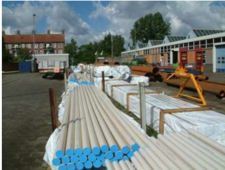
Foto bij onderdeel 1 van checklist 3.3 Buizen met 'hygiëne kappen' (doppen) en afdekfolie.
