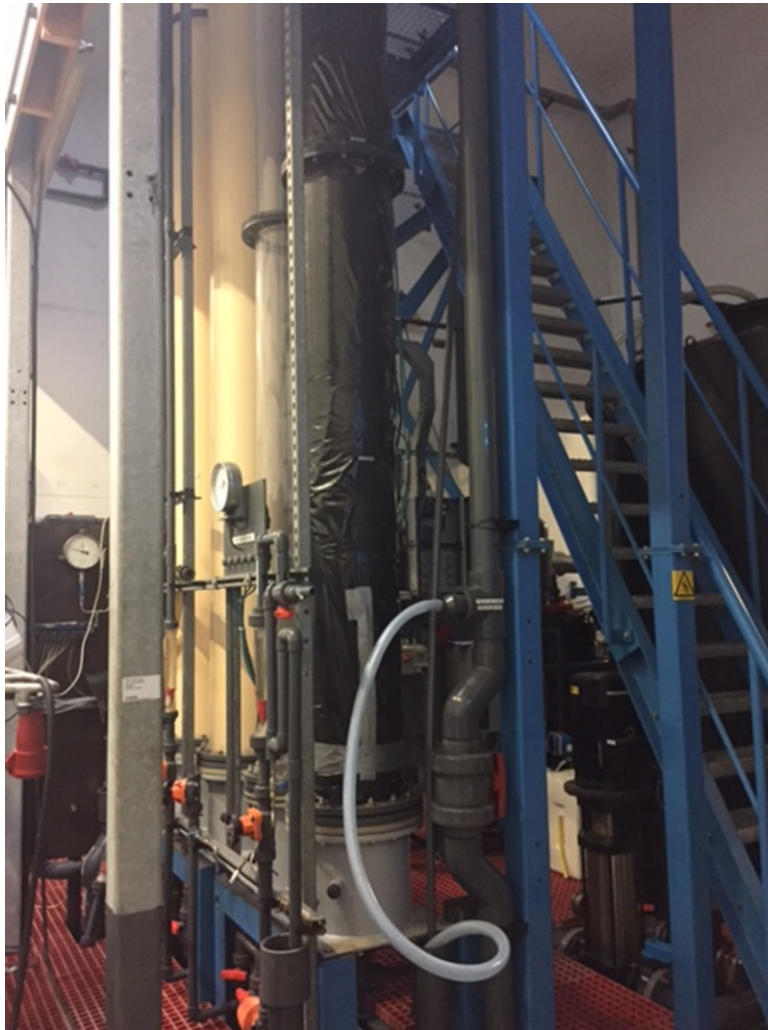
FIGUUR 3-2: FOTO VAN DE OPSTELLING BJI PWN
