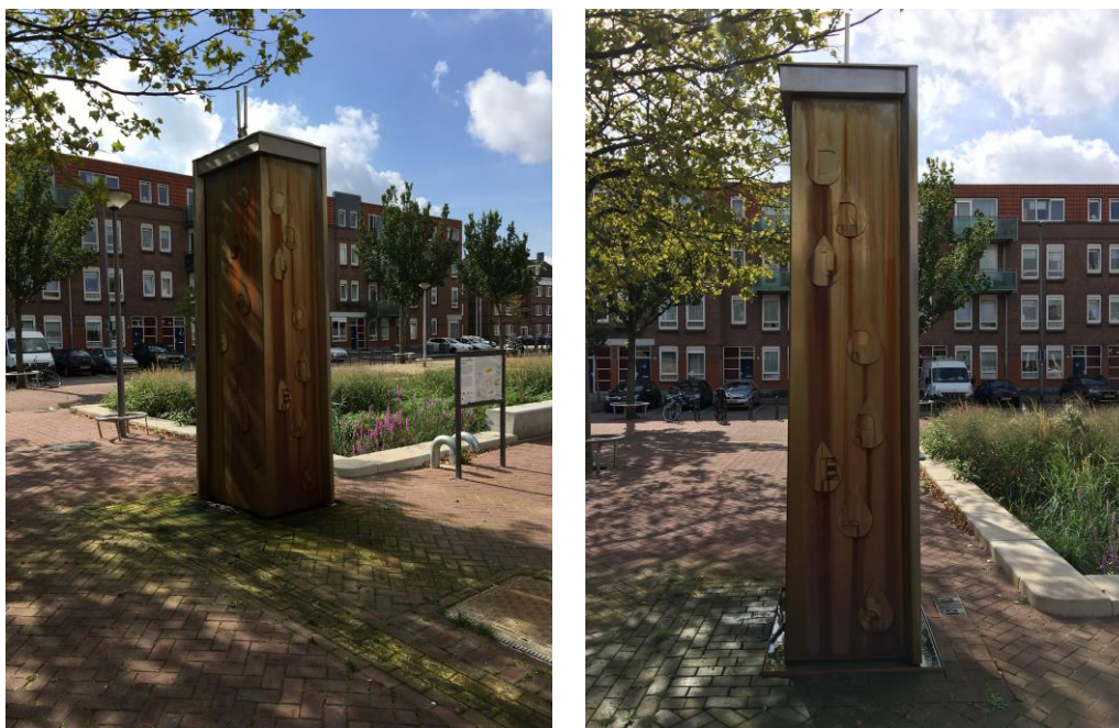
Figuur 5-25: Hoge concentraties ijzer in het winwater leiden tot neerslagen op de waterzuil. Dit wordt door ontwerper en buurtbewoners echter als 'gewenst' beschouwd om dat het de zuil een meer natuurlijke uitstraling geeft. Het wordt daarom niet verwijderd.
