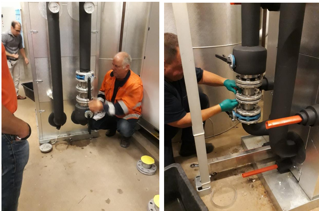
Figuur 3-9. Uitneembare segmenten in de drinkwaterleiding bij de warmtewisselaar. Links de segmenten aan de ingaande kant van de warmtewisselaar. Rechts de segmenten aan de uitgaande kant van de warmtewisselaar.
