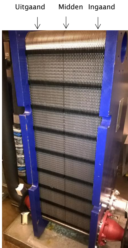
Figuur 3-11. De warmtewisselaar zonder de beschermende kast. De individuele platen zijn zichtbaar.
