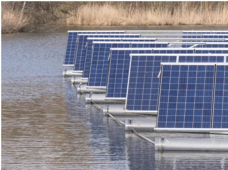
Drijvende zonnepanelen op een drinkwaterwingebied
