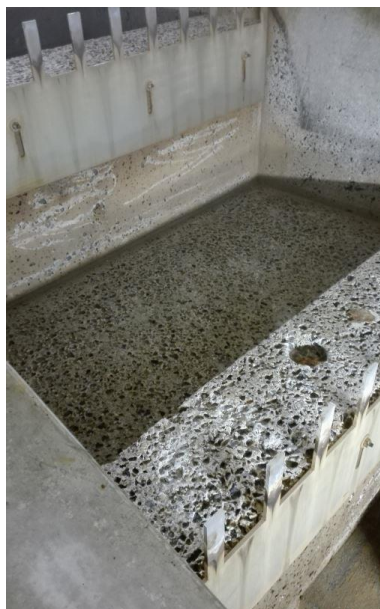
Figuur 3-1 Voorbeeld van aangetast beton als gevolg van het toepassen van verkeerde kalksteen.
