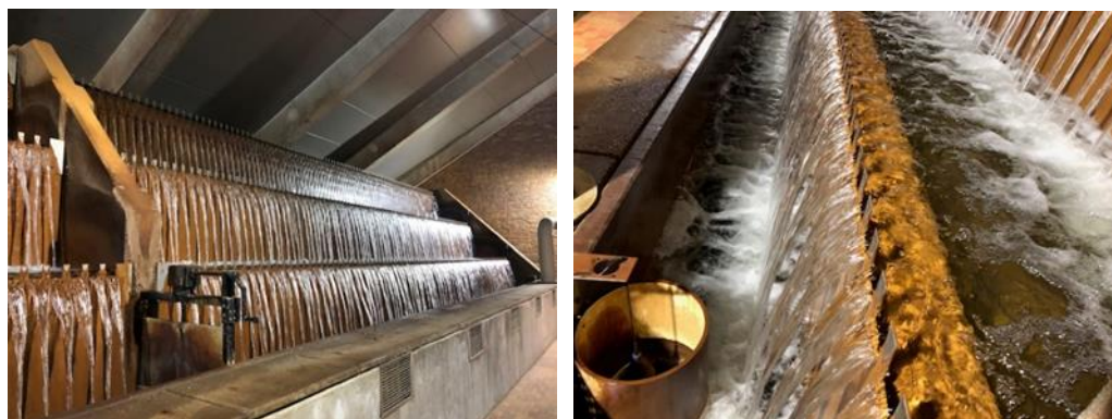
Figuur 2-6 Een cascadebeluchting op drinkwaterproductielocatie 'Prinsenbosch' van drinkwaterbedrijf Brabant Water (foto's Brabant Water).
