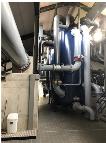
Figuur 2-4 Een tegenstroom-beluchtingstoren op drinkwaterproductielocatie 'Veghel' van drinkwaterbedrijf Brabant Water (foto Brabant Water).
