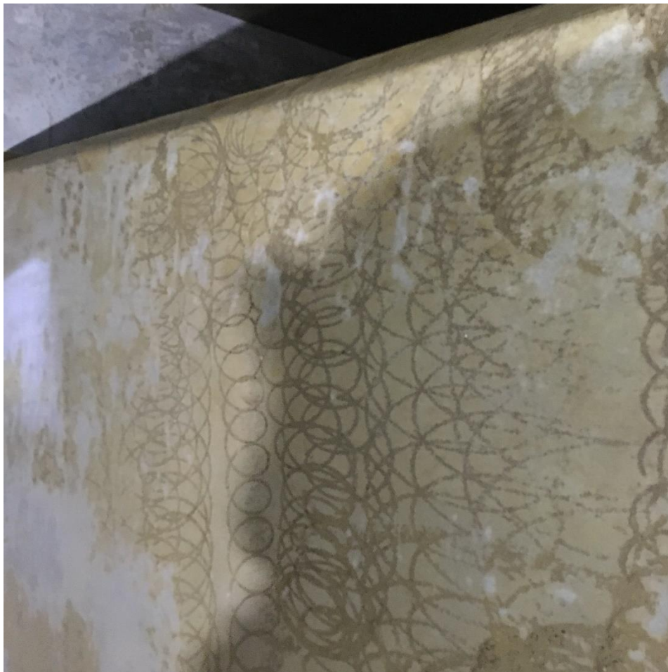
Foto 1 Beschadiging van de betonnen wanden van de chloorcontactkelder van drinkwaterproductielocatie Weesperkaspel als gevolg van te hoge druk (foto Waternet).
