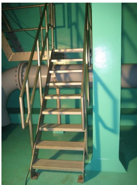
Foto 4 Roestvaststalen trap in een reservoir (foto Vitens) 17 .
