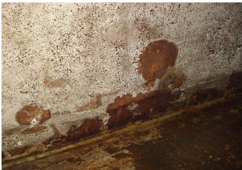
Foto 21 Biofilmvorming ter plaatse van vloer-wand aansluiting.
