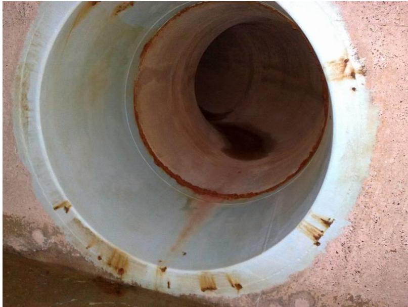
Foto 24 Beschadigde coating en corrosie aan ingestorte stalen doorvoer.
