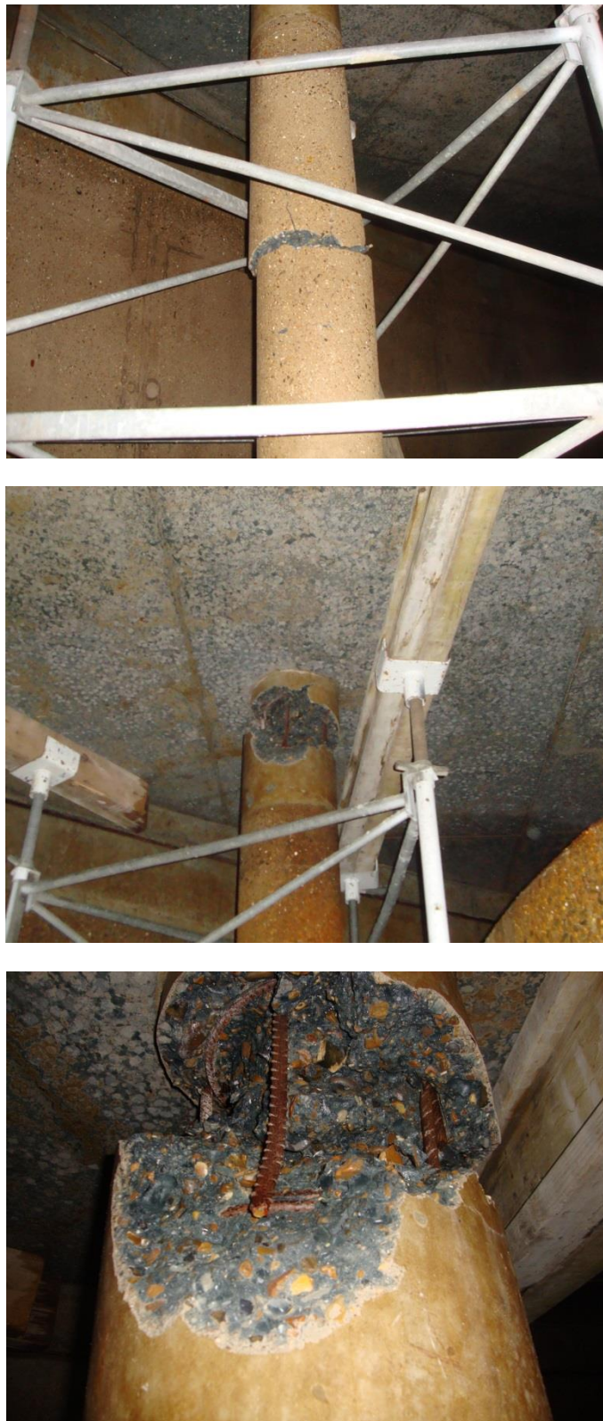
Foto 9 De gevolgen van het opdrukken van het dak van een reservoir (foto's PWN).
