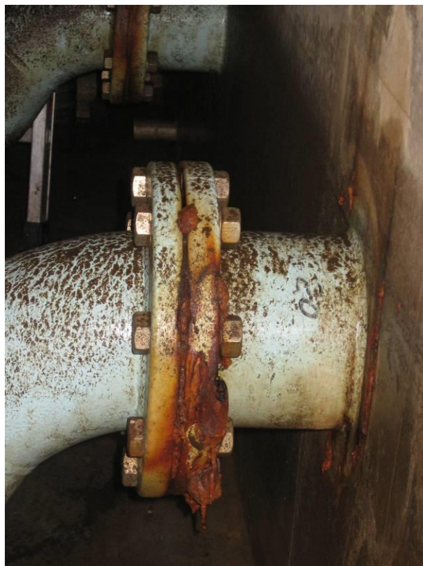
Foto 25 Corrosie van ingestort muurdoorvoerstuk.
