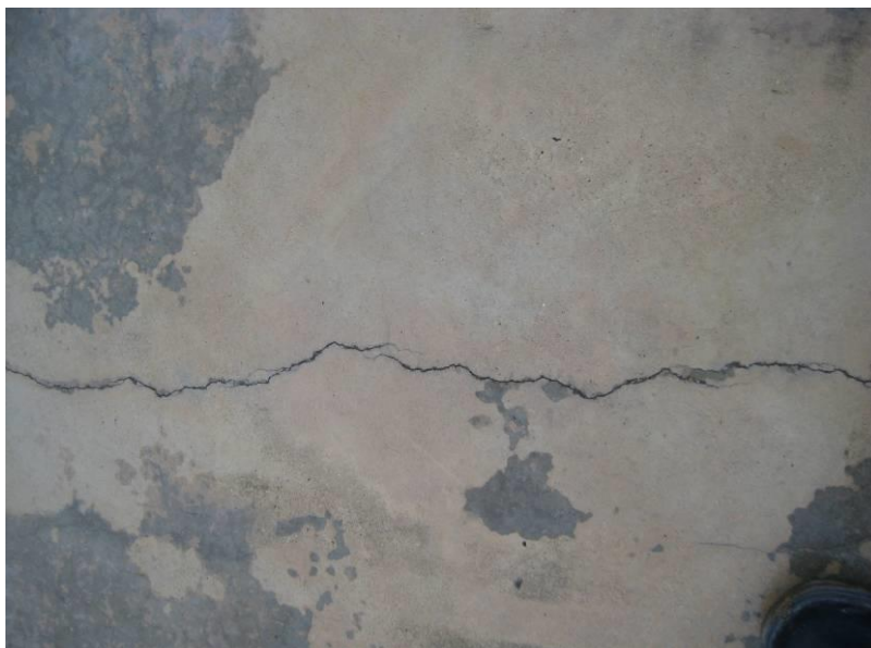
Foto 15 Scheurvorming in wandconstructie.
