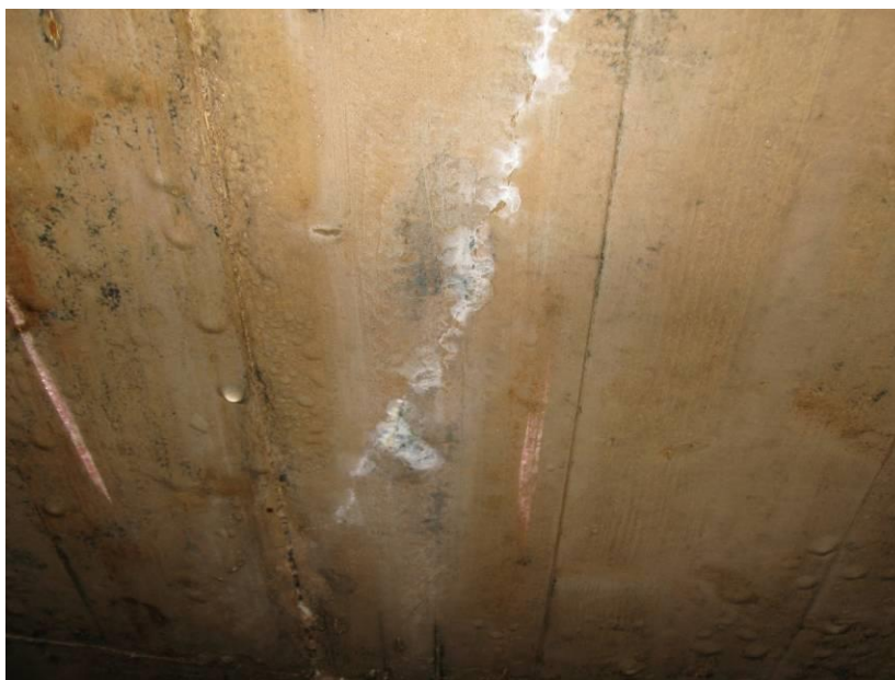
Foto 18 Kalkuitbloeiingen ter plaatse van scheurvorming in een dek.
