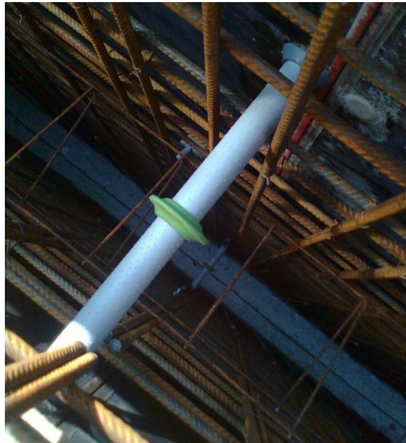
Foto 27 Dichtingsring uit zwelmateriaal op centerpenhuls (foto Pidpa).
