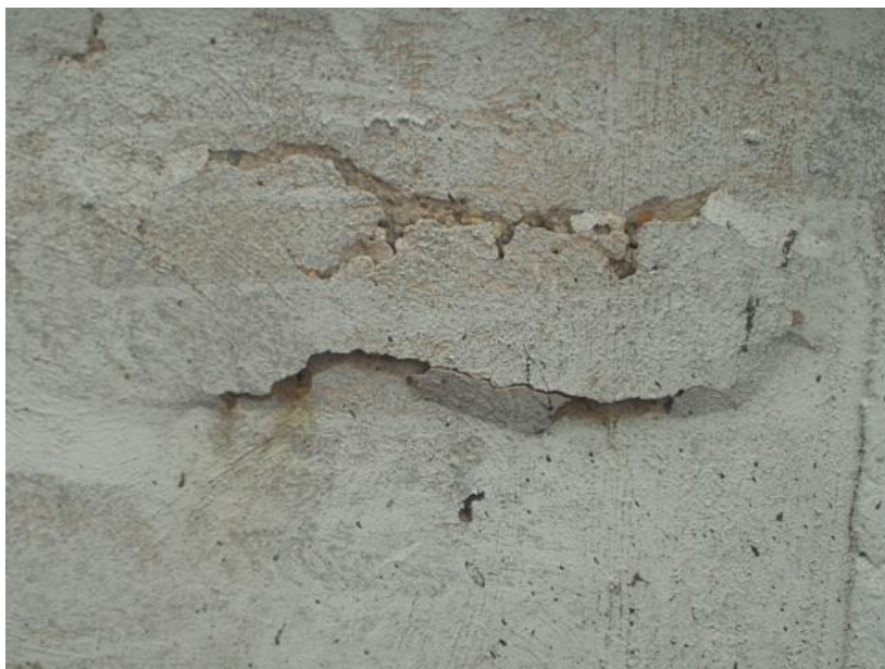
Foto 16 Afgedrukte betondekking (scholvorming) als gevolg van corrosie door onvoldoende betondekking.
