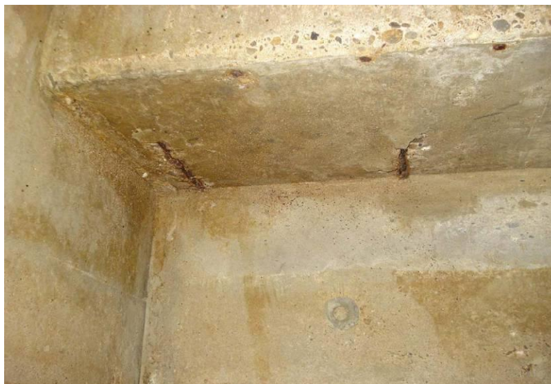
Foto 17 Plaatselijk corroderende wapening als gevolg van onvoldoende betondekking.
