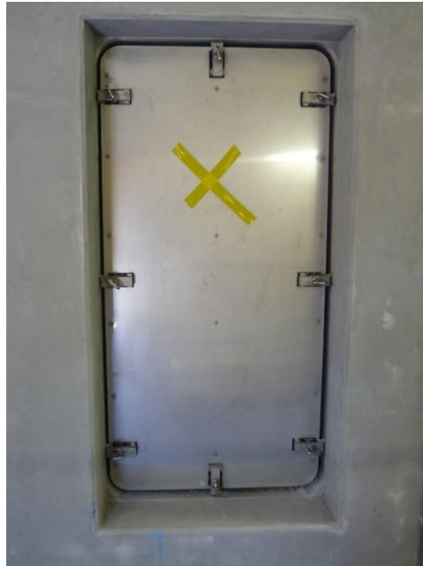
Foto 2 Waterdichte deur in een reservoir (foto Vitens).
