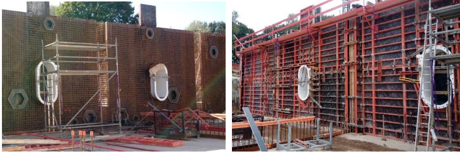
Foto 11 Wand van een drinkwaterreservoir in aanbouw, voor én na sluiting van de systeembekisting. Zowel rechtstreeks in te storten doorvoeren (witte ovale mangaten) als bekistingen voor sparingen zijn toegepast (foto's Pidpa).
