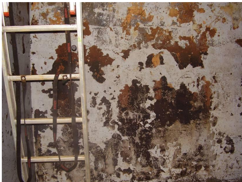
Foto 23 Beschadigde coating op wandconstructie als gevolg van erosie.
