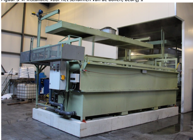
Figuur 3-5: Installatie voor het koken van de leliebollen met chloor, bedrijf 1
