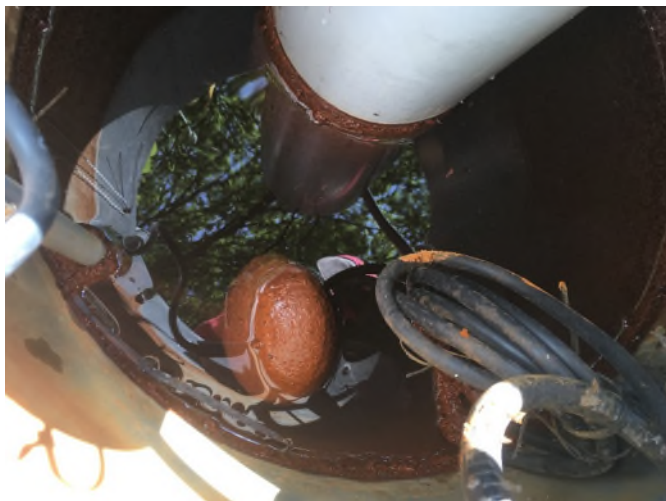
Figuur 1-6: Vlottersysteem dat zorgt voor de aansturing van de pomp als functie van de waterstand in de regelput bij de grondwaterproef in America.
