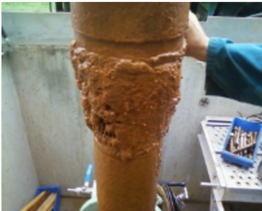
Grondwaterputten raken regelmatig verstopt door accumulatie van neerslagen, gevormd door oxidatie van ijzer uit het grondwater.
