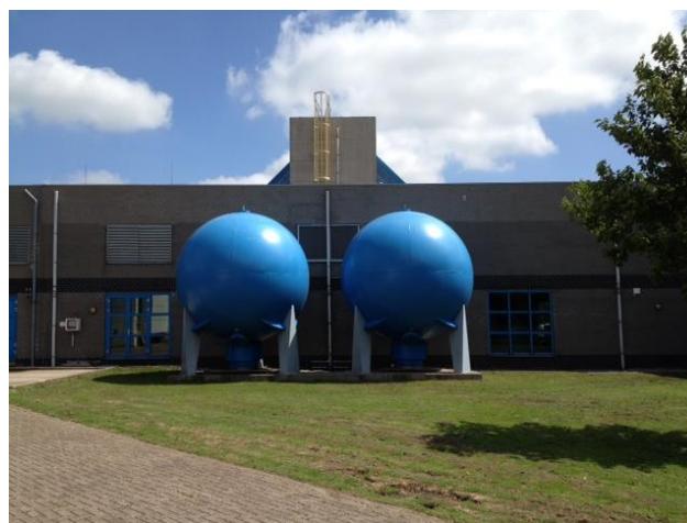
Waterslagtanks op zuiveringsstation 'De Steeg' (foto: drinkwaterbedrijf Oasen).
