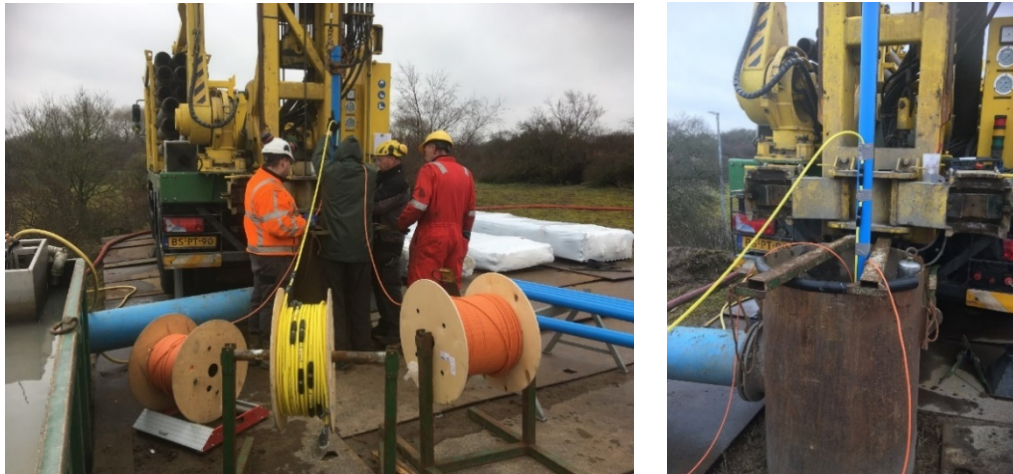
FIGUUR 4-10: INSTALLATIE (A) EN BEVESTIGING (B) VAN DE ZOUTWACHTERKABEL (GEEL) EN DE GLASVEZELKABEL (ORANJE) AAN DE DIEPSTE PEILBUIS.
