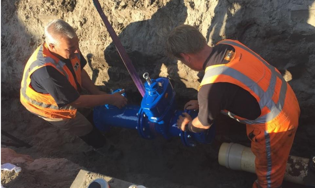
Figuur 3 – De bypass moet worden voorzien van een afsluiter. Bij de aanleg moet hygiënisch worden gewerkt.
