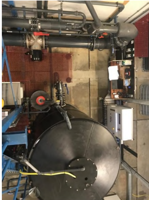
Pilot-installatie op de proeflocatie van PWNT in Andijk
