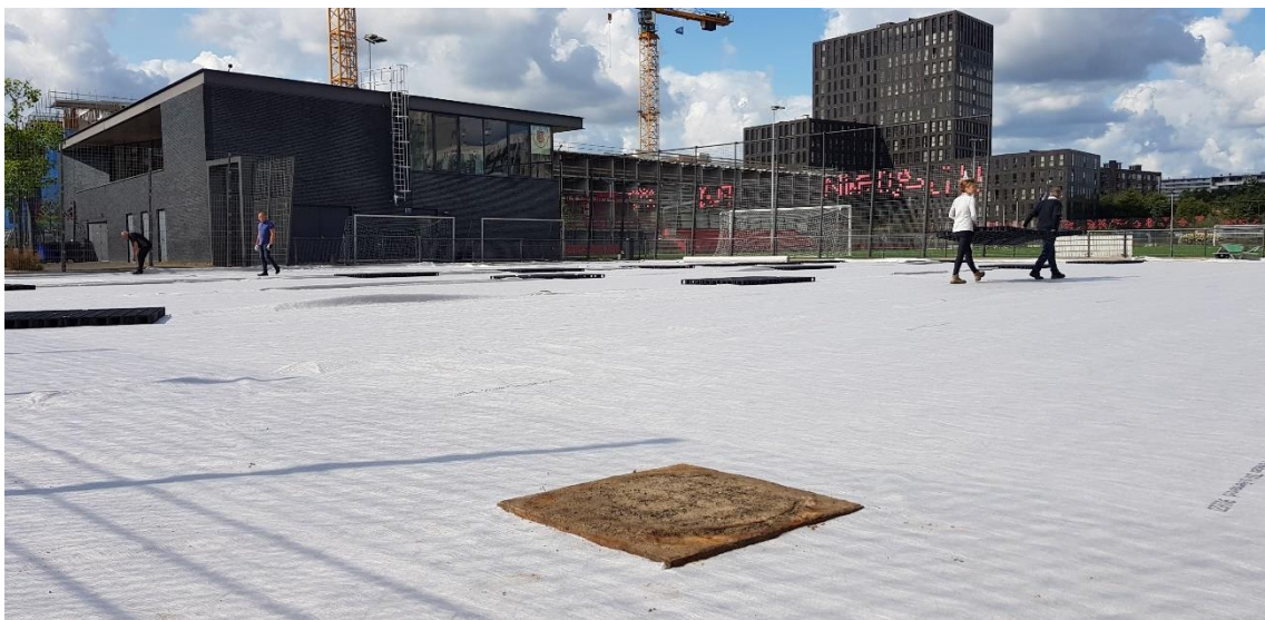
Figuur 17 Oude putdeksel steekt door de folielaag
