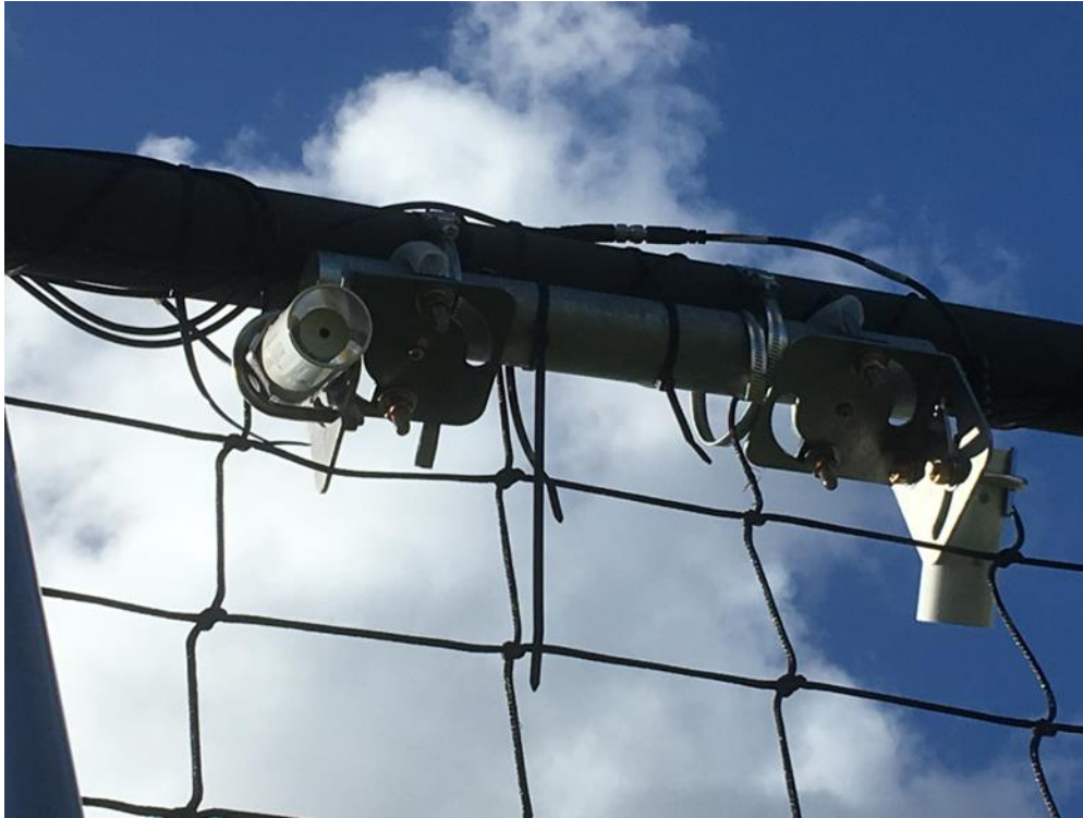
Figuur 13 De oppervlaktetemperatuur van het capillair geïrrigeerde trainingsveld en naastgelegen standaard veld met kurkinfill worden gemeten met Infraroodsensoren vanaf de ballenvanger
