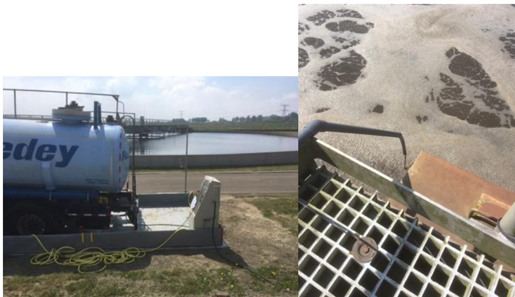
Afbeelding 1. Opslag van het vlokmiddel en dosering op de RWZI in Bath (WBD)
