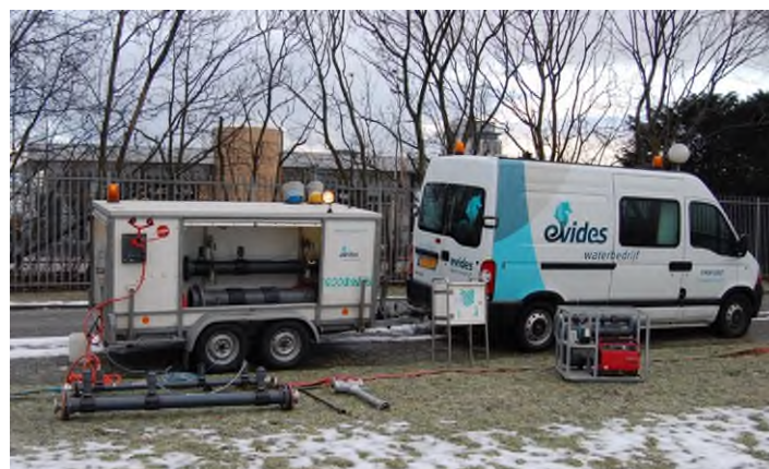
Foto 23 Voorzieningen voor de eventuele desinfectie van leidingen na waterkwaliteitsbeoordeling (checklist 3.7, onderdeel 18).
